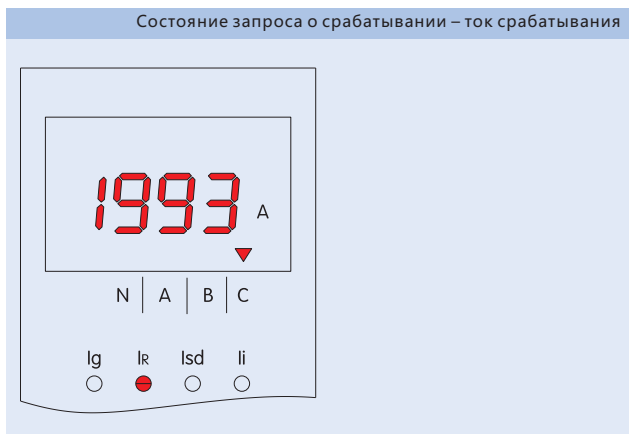
Состояние запроса о срабатывании – ток срабатывания
